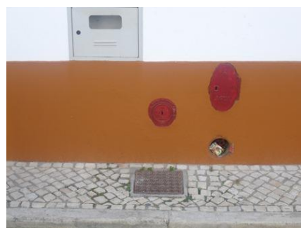
Figura 26 – Foto caixa contador AG
