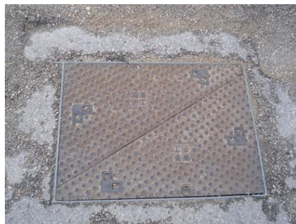
Figura 30 – Câmara de visita de telecomunicações
