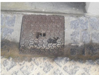
Figura 22 – Foto caixa ramal DOM
