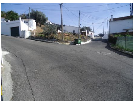
Figura 59 – Vista de arruamento sem passeios
