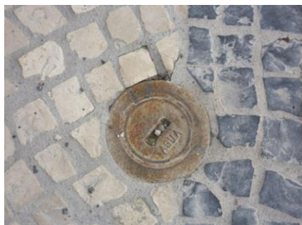
Figura 23 – Foto tampa válvula seccionamento rede AG
