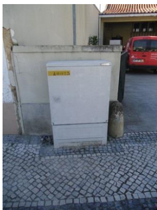
Figura 27 – Foto armário distribuição
