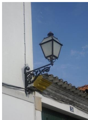
Figura 28 – Cablagens suspensas e luminárias aplicadas em fachadas
