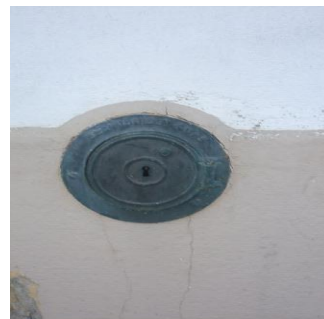
Figura 24 – Foto torneira ramal
