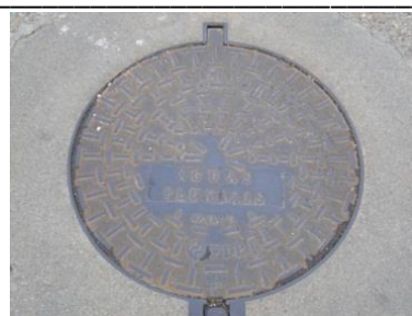
Figura 19 – Foto tampa rede PLU
