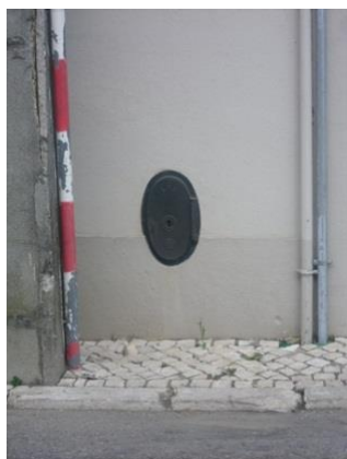
Figura 25 – Foto boca de incêndio
