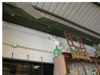
Vista interior e respetivas patologias
